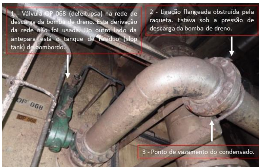
Figura 2: Válvula e ligação flangeada, responsável pelo vazamento. Fonte: Adaptado de Marinha do Brasil, 2015.
