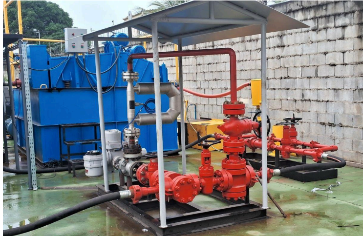
Figura 1: Medidor de vazão Coriolis e válvula choke
