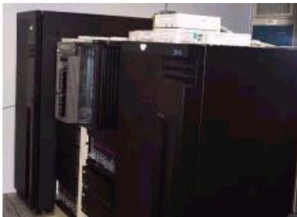
Figura 2. Instalação Petrobank® CDA
