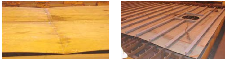
Figura 1: Distorções causadas após processos de soldagem.
