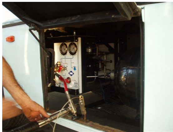
Figura 10. Central de abastecimento do GASBUS, facilidade ergonômica de operação dos instrumentos.
