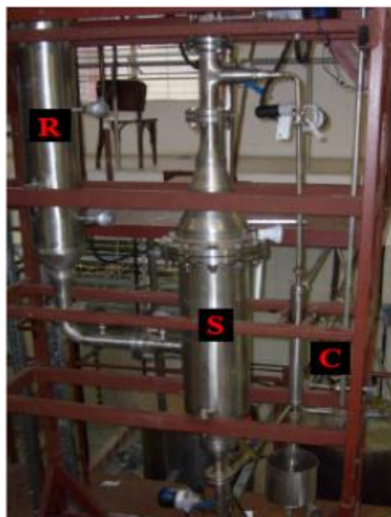
Figura 2: Fotografia da instalação da unidade piloto DiCTT: Reator (R), Separador Gás-Líquido (S) e Condensador (C).
