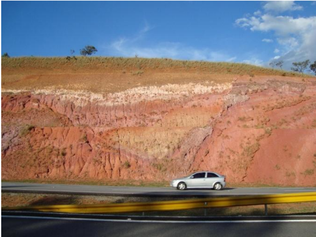
Fig. 2: Fotografia de falha rotacional na bacia na encosta da Rodovia SP-070.
