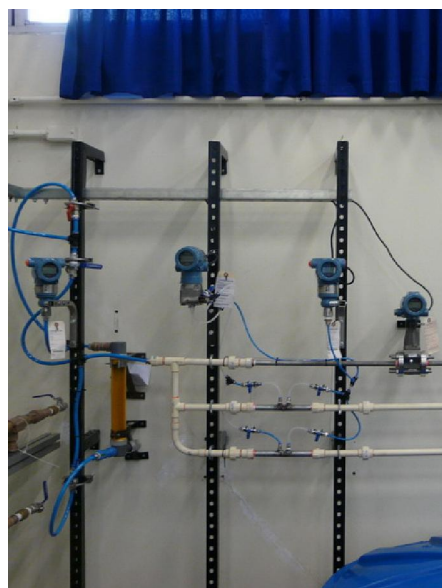
Figura 2 – Instrumentação padrão industrial – projetada e montada na UTFPR
