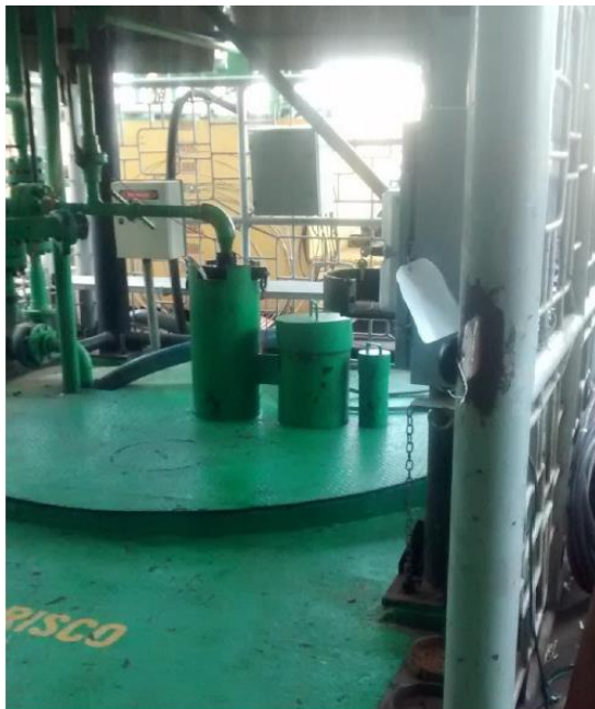
Figura 6 - Poço experimental de Bombeio Centrífugo Submerso
