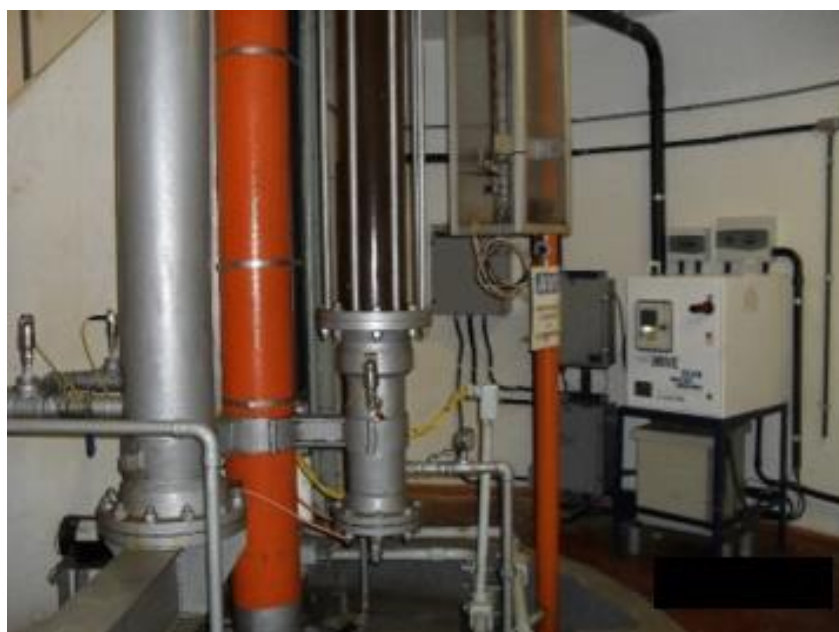
Figura 8. Estrutura de sensoriamento do fundo do poço
