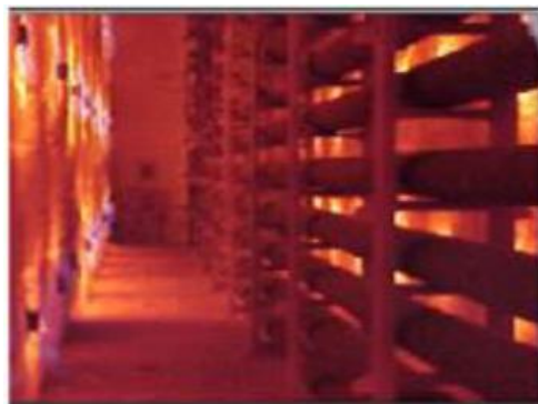
Figura 2 – Vista interna da seção radiante.
